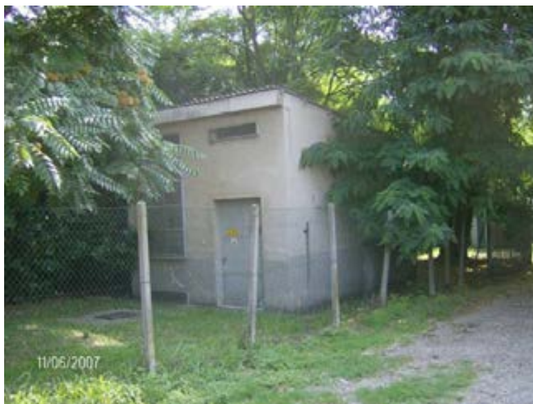
Cabina di riduzione di Fasolo
