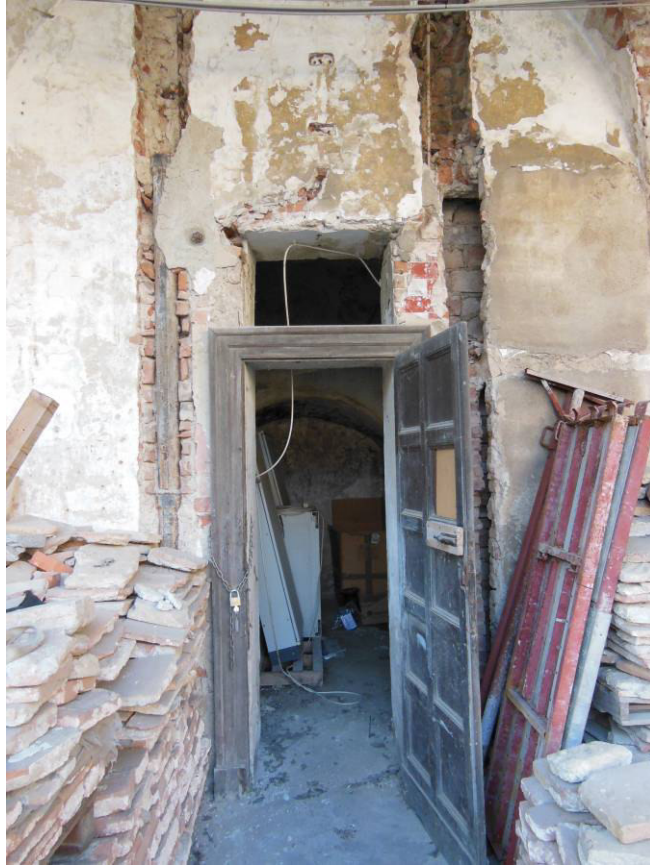
ACCESSO LOCALE T34
