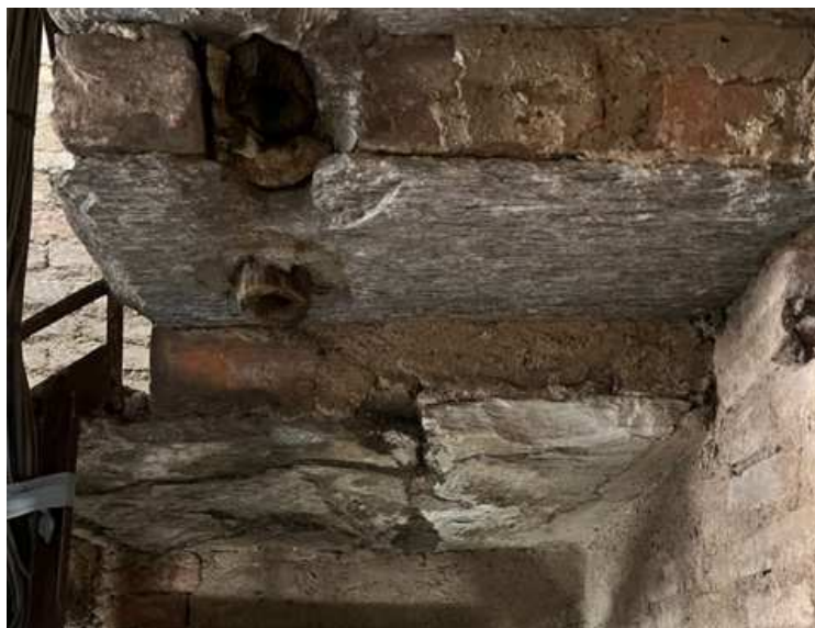
Vista interna: pedate in pietra fessurate
