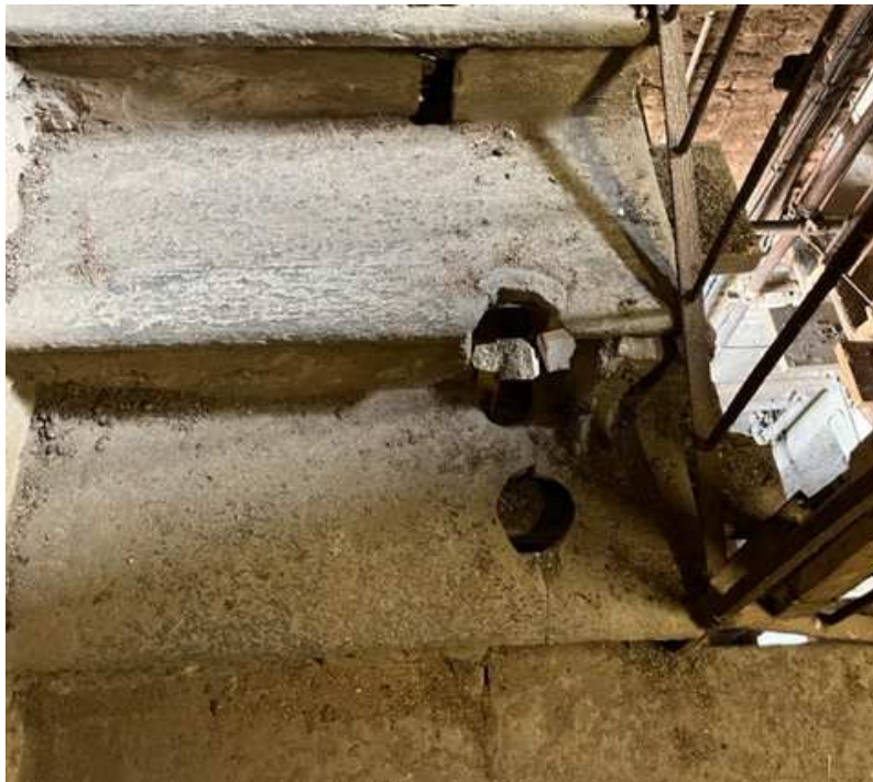
Vista interna: dettaglio pedate in pietra con fori o rotture
