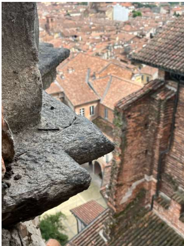
Fotografia n. 14 Dettaglio cornice in pietra fessurata
