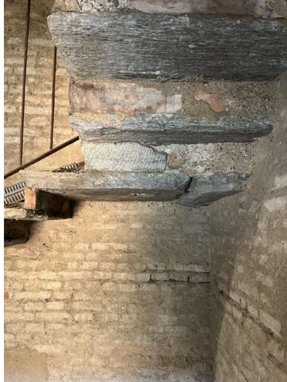
Fotografia n. 27 Vista interna: dettaglio pedate in pietra fessurate
