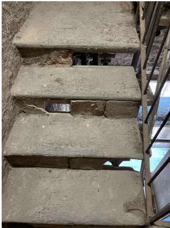
Fotografia n. 23 Vista interna: dettaglio delle alzate in laterizio intonacato degradate e con parti mancanti/fratturate
