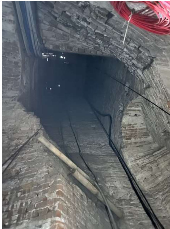
Fotografia n. 16 - Vista interna: murature sopra quota solaio a +4,55 m: si notano gli archi in muratura sui lati sinistro e destro reggenti porzioni di muratura.
