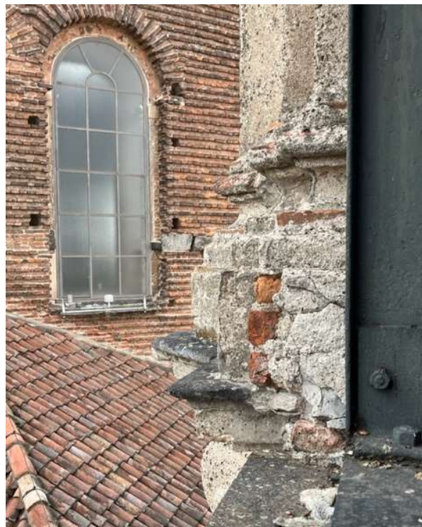
Fotografia n. 12 Distacchi di porzioni di intonaco esterno cella campanaria
