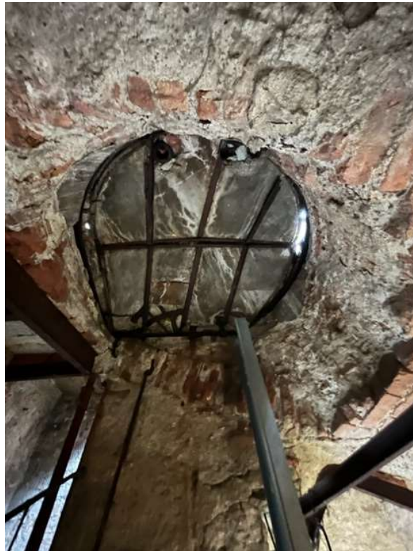
Fotografia n. 30 Vista interna: soletta in putrelle e tavelloni intonacati di chiusura del foro cella campanaria
