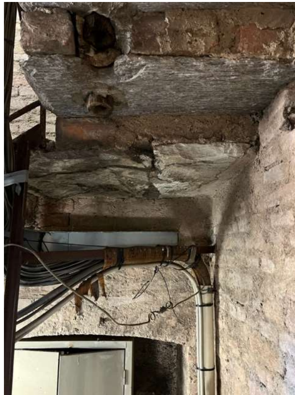
Fotografia n. 26 Vista interna: pedate in pietra fessurate
