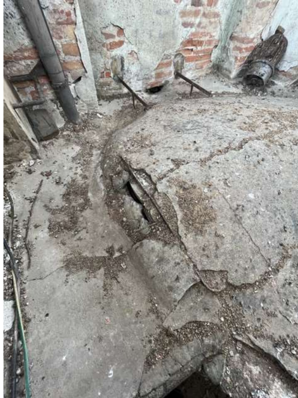
Fotografia n. 11 Soletta in calcestruzzo cella campanaria, pericolante
