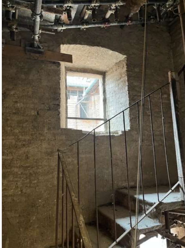
Fotografia n. 25 Vista interna: parapetto scale in ferro ossidato e deformato
