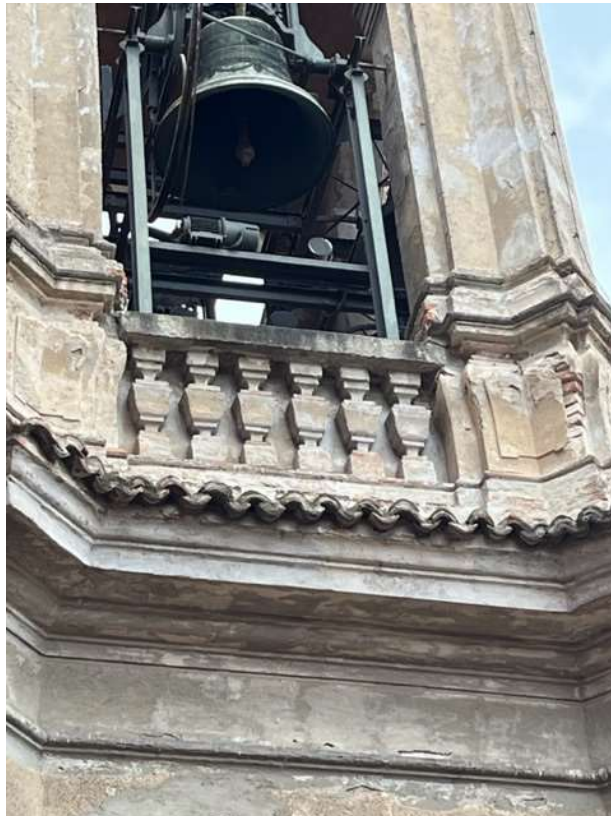
Fotografia n. 8 Fenomeni di erosione e sfarinamento dell'intonaco.
