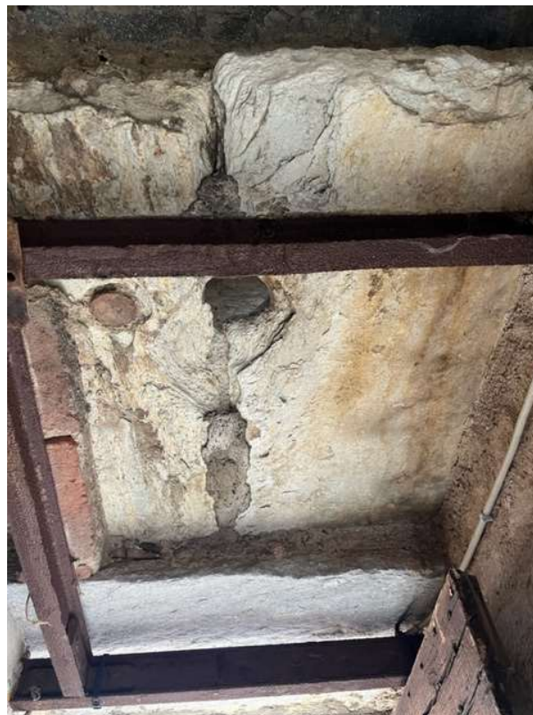
Fotografia n. 28 Vista interna: elementi metallici di consolidamento ormai completamente ossidati pertanto con ridotta resistenza meccanica
