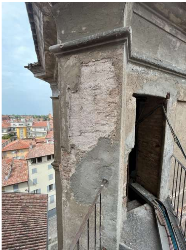
Fotografia n. 9 Fenomeni di distacco di porzioni significative di intonaco.
