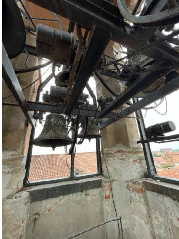
Fotografia n. 13 Impianto campanario non funzionante
