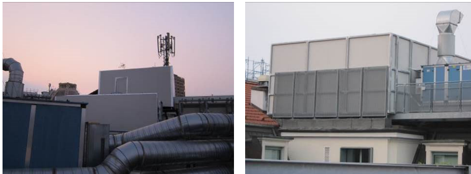
Figura n. 24: Esempi di schermature realizzate ad impianti
