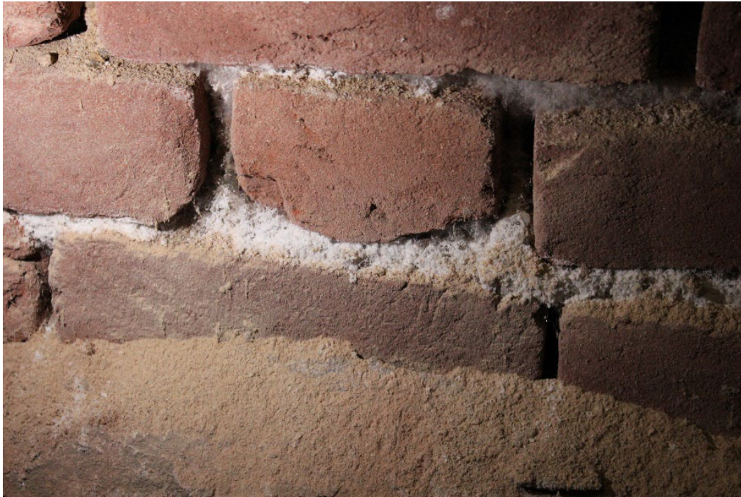
Presenza di efflorescenze saline alla base delle murature
