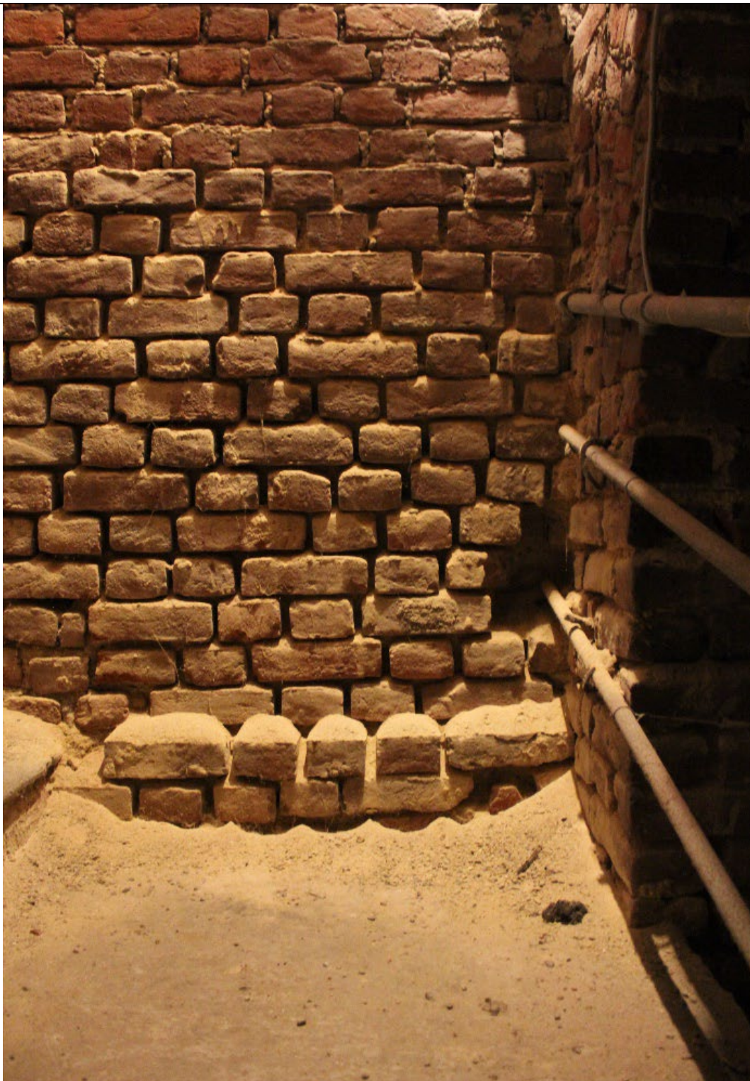
Disgregazione della malta tra i giunti, si osservi l'accumulo di materiale accumulato a terra
