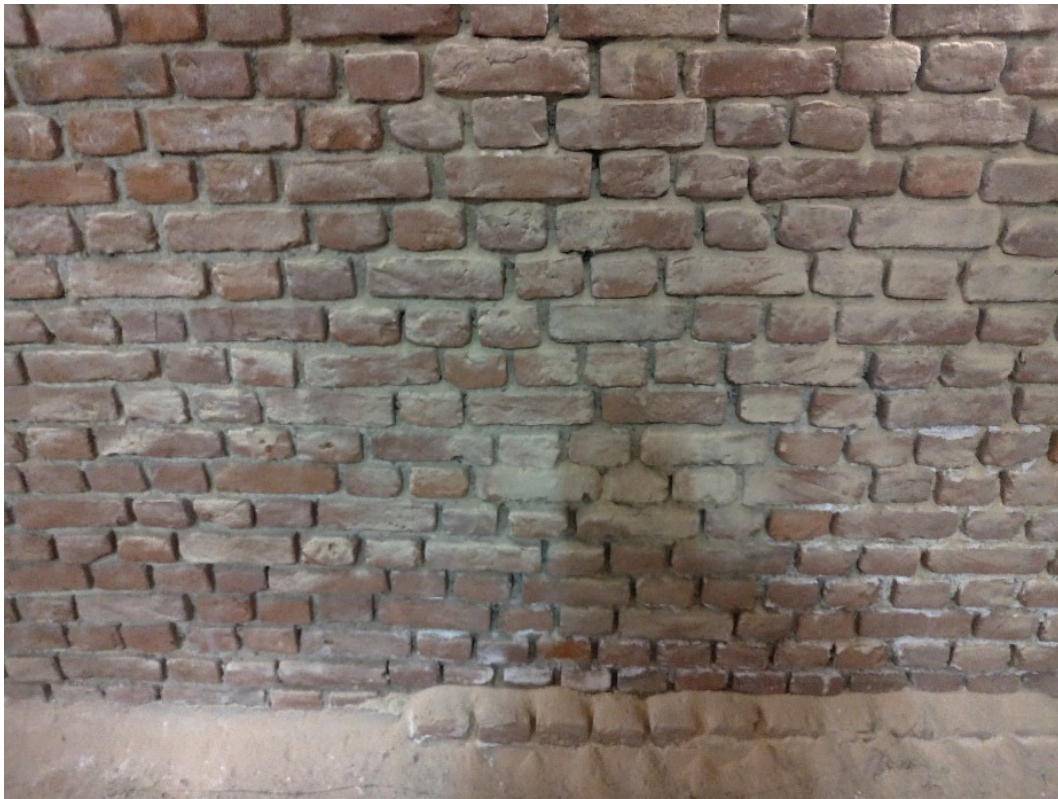
Paramento murario con disgregazione della malta di allettamento
