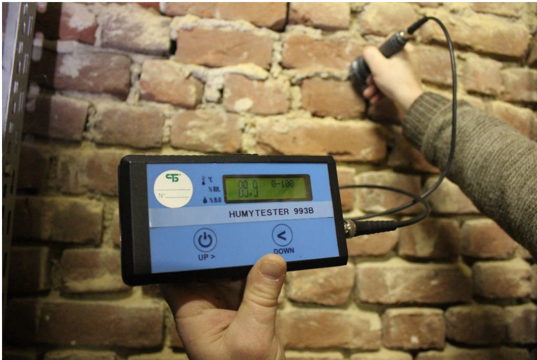
Umidità di risalita capillare rilevata con Humitester 993B con piano di gora di ca mt. 1,30
