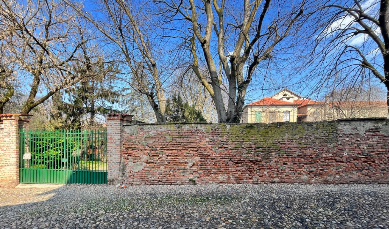
Figura 23 Muro Esistente da mettere in sicurezza e creare nuovo varco
