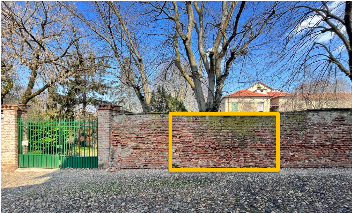
Figura 13 Muro fuori piombo da demolire e ricostruire con gli stessi mattoni esistenti. In giallo il varco che ospiterà il nuovo cancello (veri render sottostante)
