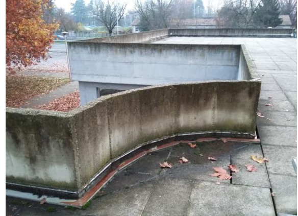
Parapetti in c.a. con finitura faccia a vista priva di protezione agli agenti atmosferici
