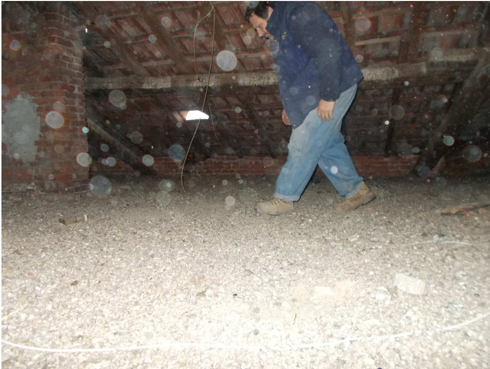
Foto 7 - Particolare diffusa presenza di guano di piccione
