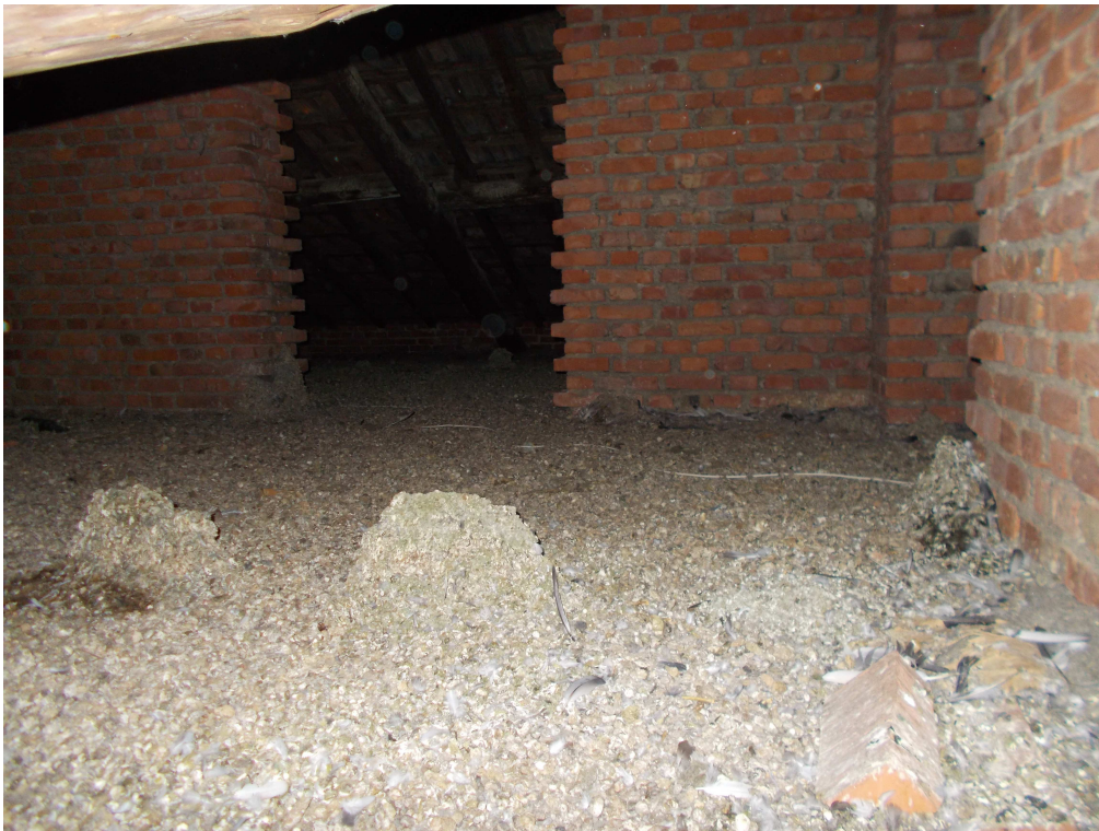
Foto 6 - Particolare diffusa presenza di guano di piccione
