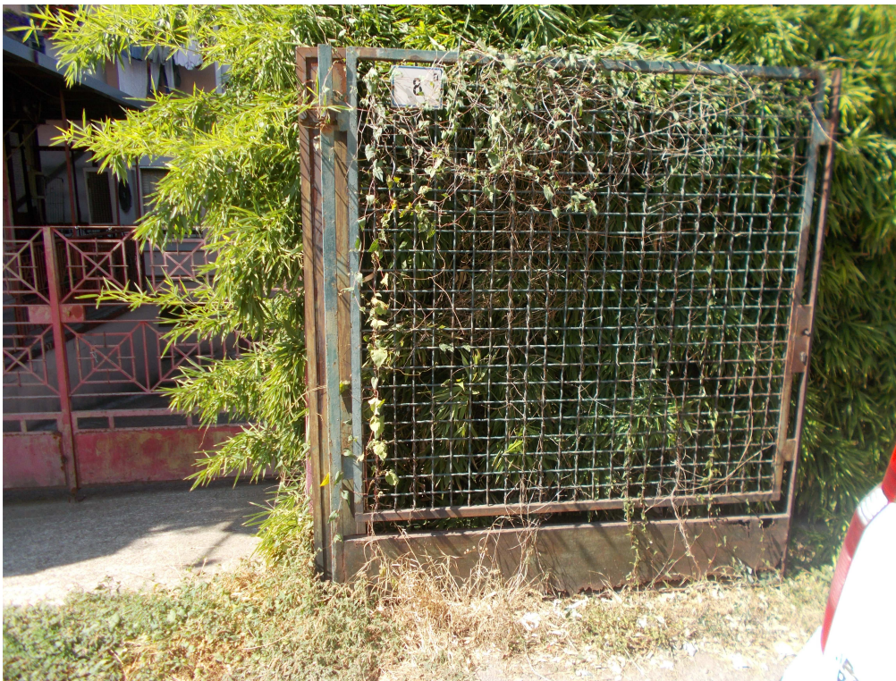
Foto 15 - Stato di degrado del cancello
