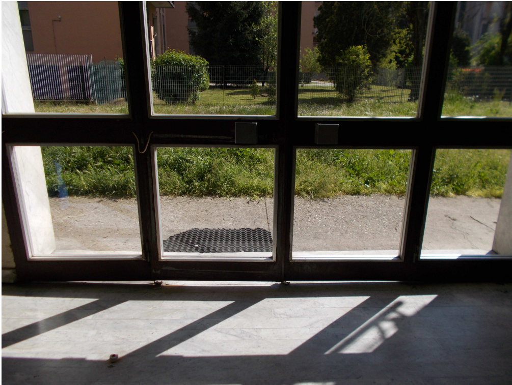
Foto 12 - Particolare abbassamento della pavimentazione di ingresso
