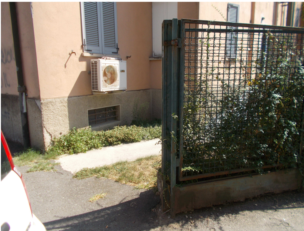
Foto 16 - Stato di degrado del cancello
