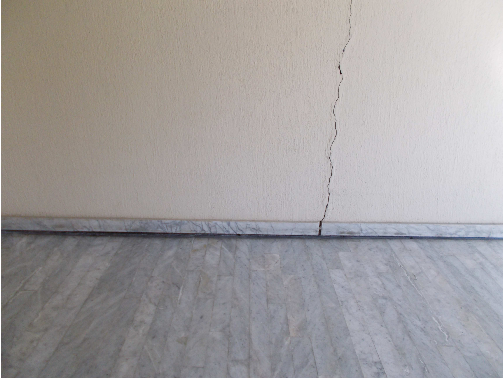
Foto 13 - Particolare abbassamento della pavimentazione in marmo
